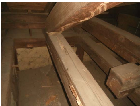
【圖 4-1-14】X7 架陸梁目視結果顯示白蟻蛀蝕危害嚴重
