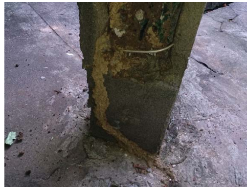
【圖 4-1-17】床束基礎發現白蟻沿犬走基礎裂隙構築遮蔽管入侵建築物
