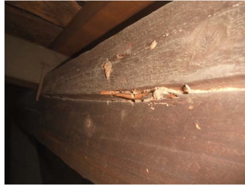
【圖 4-1-11】母屋開裂孔隙內發現白蟻蛀蝕蟻道
