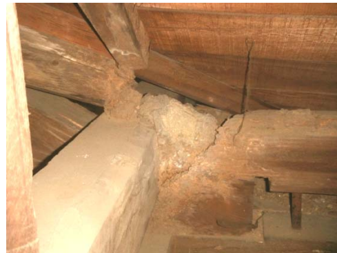
【圖 4-1-13】和洋館搭接處陸梁構件發現白蟻副巢，以乾燥無活體。
