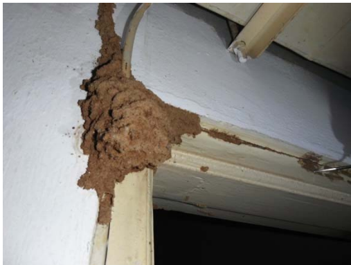
【圖 4-1-16】洋館門框交接處白蟻構築副巢，檢視仍有活體持續危害
