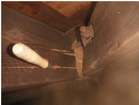
【圖 4-1-12】Y1 架人字樑搭街位置白蟻構築蟻道
