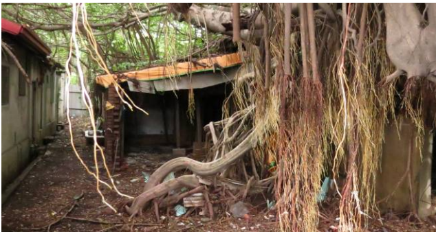
【圖 5-2- 10】後院增建的房間傾毀
