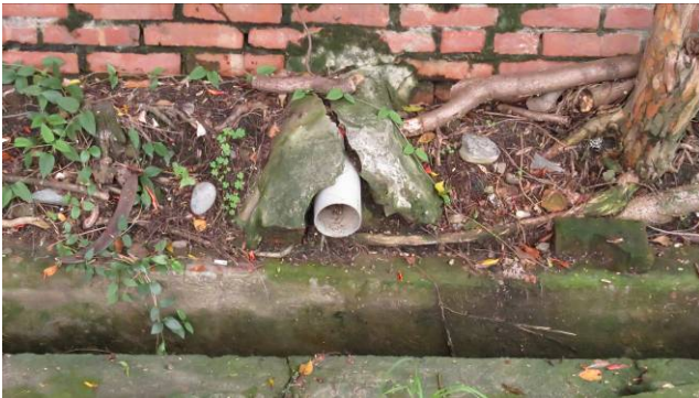
【圖 5-2- 8】增建衛浴空間直接排放至側牆溝渠
