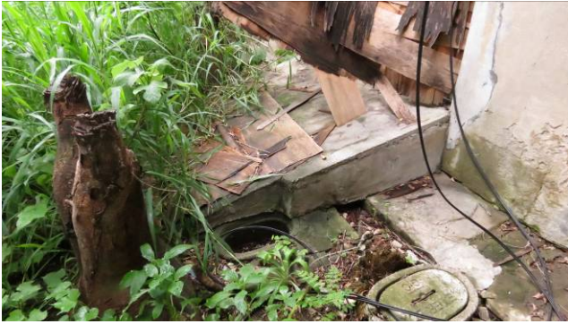
【圖 5-2- 6】犬走外的排水溝已淤積破壞
