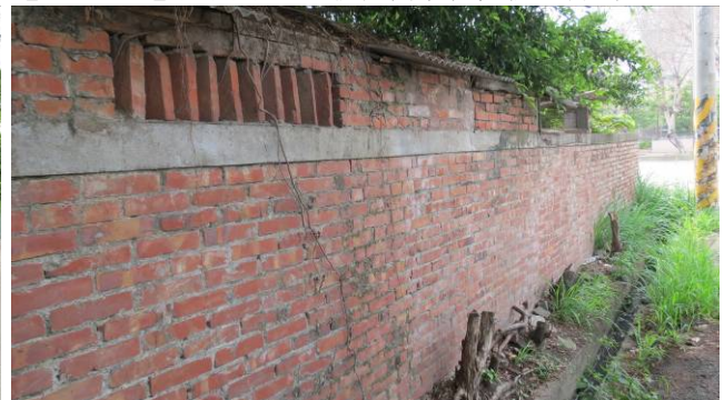
【圖 5-2- 5】增建直接搭建於側牆之上
