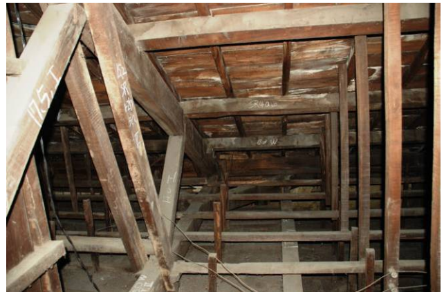
【圖 5-1- 29】左側木屋架為前期浴場與脫衣場間的分隔位置，與現在中間所見橫樑（現況的隔間線）不同。
