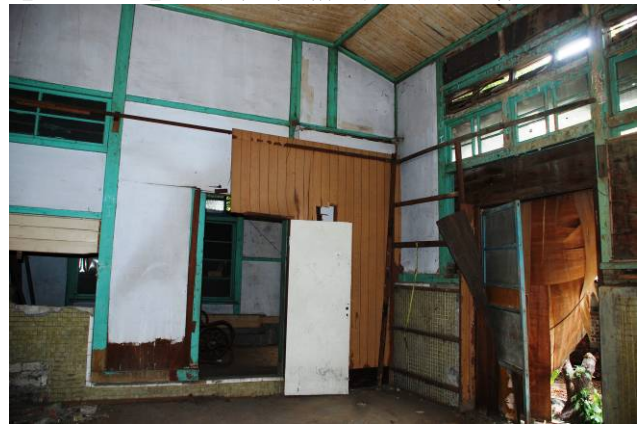
【圖 5-1- 37】浴室空間的天花板設計便於水蒸氣凝結落下的形式，大面開窗便於採光與通風。
