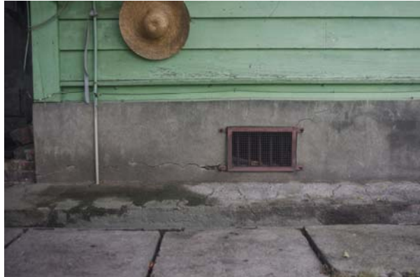
【圖 4-2-27】通氣孔之角隅斜向、水平裂縫 (洋館)
