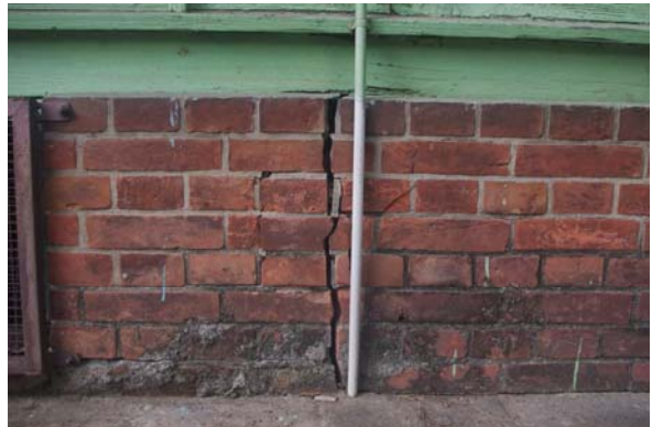
【圖 4-2-28】北側角隅磚造基牆開裂 (和館)
