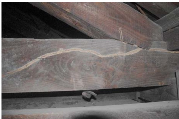
【圖 4-2-32】陸樑木構件白蟻蟻道
