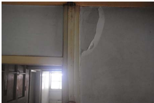
【圖 4-2-29】牆體角隅之粉刷層浮凸、開裂
