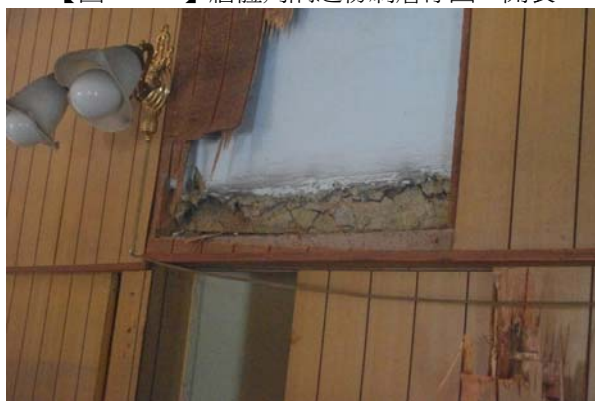
【圖 4-2-31】後期裝修造成之牆體破損
