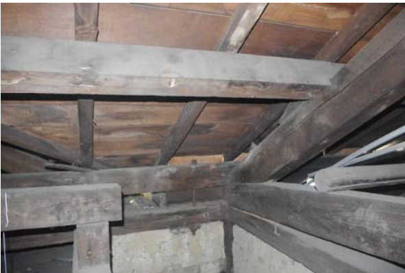
【圖 4-2-36】木料受潮腐朽
