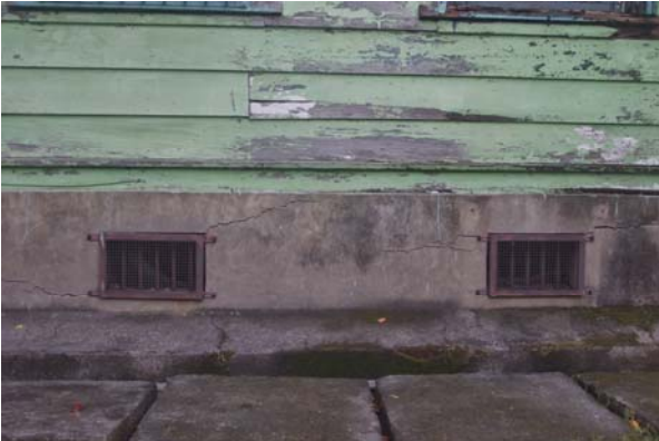
【圖 4-2-26】通氣孔之角隅斜向、水平裂縫 (洋館)
