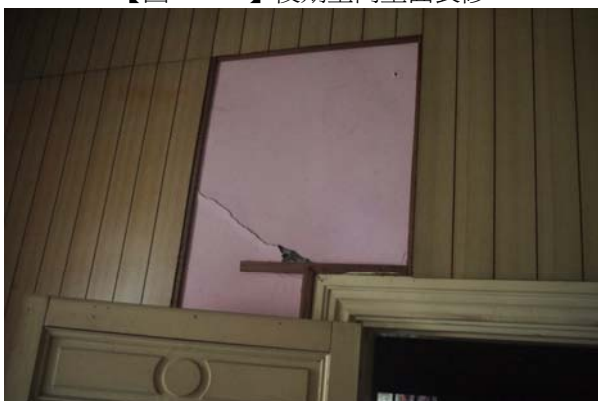
【圖 4-2-30】牆體之剪力斜向裂縫
