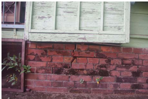
【圖 4-2-23】磚造基牆開裂 (和館)
