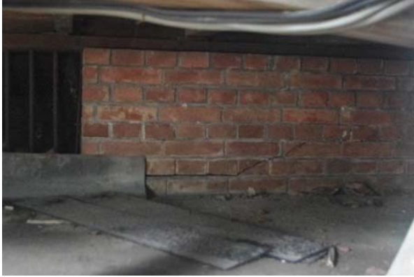
【圖 4-2-24】磚造基牆開口處水平裂縫 (和館)
