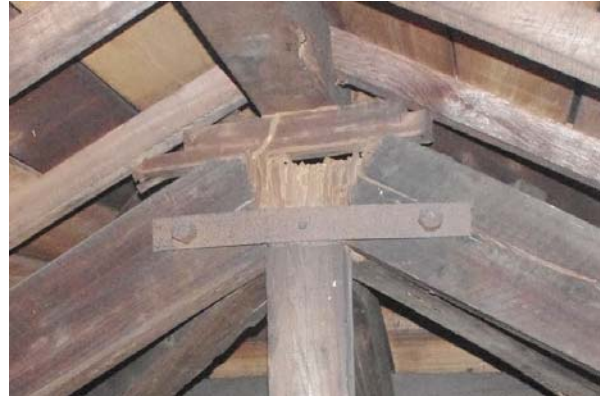
【圖 4-2-35】正同柱柱頭白蟻蛀蝕腐朽
