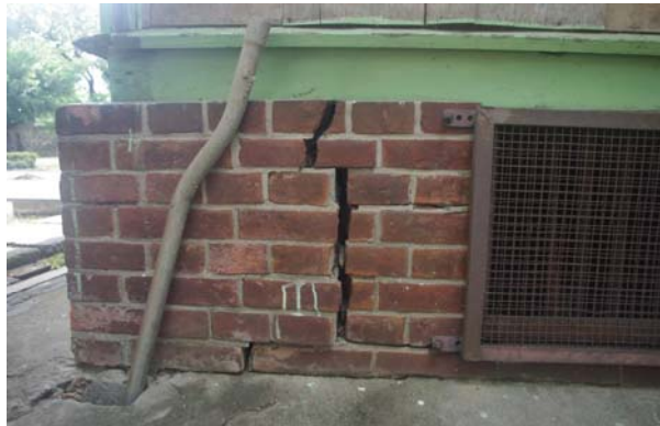
【圖 4-2-29】磚造基牆開裂、錯移 (和館)
