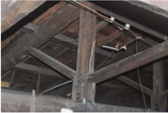
【圖圖 4-2-34】正同柱木料白蟻蟻道
