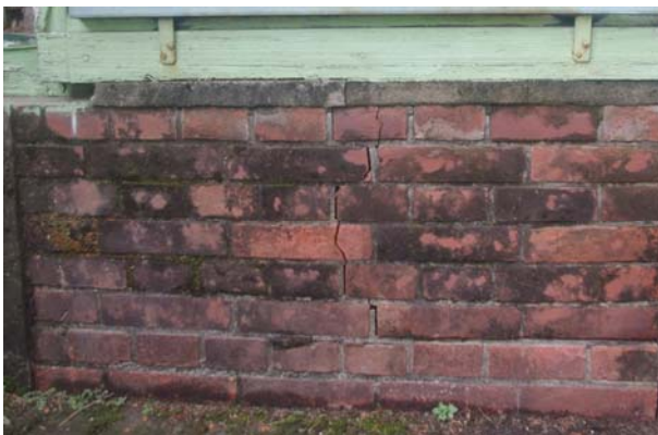
【圖 4-2-22】磚造基牆開裂 (和館)
