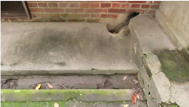
【圖 3-3- 10】建築物左側廚房排水直接延伸至屋外
