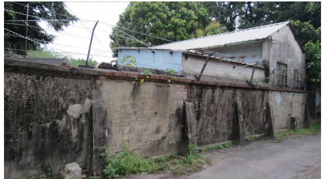
【圖 3-3- 7】林森路 25 巷外扶壁柱間隔不及 2m
