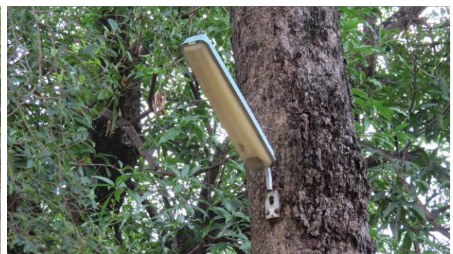
【圖 3-3- 44】木棉不當利用為電線杆
