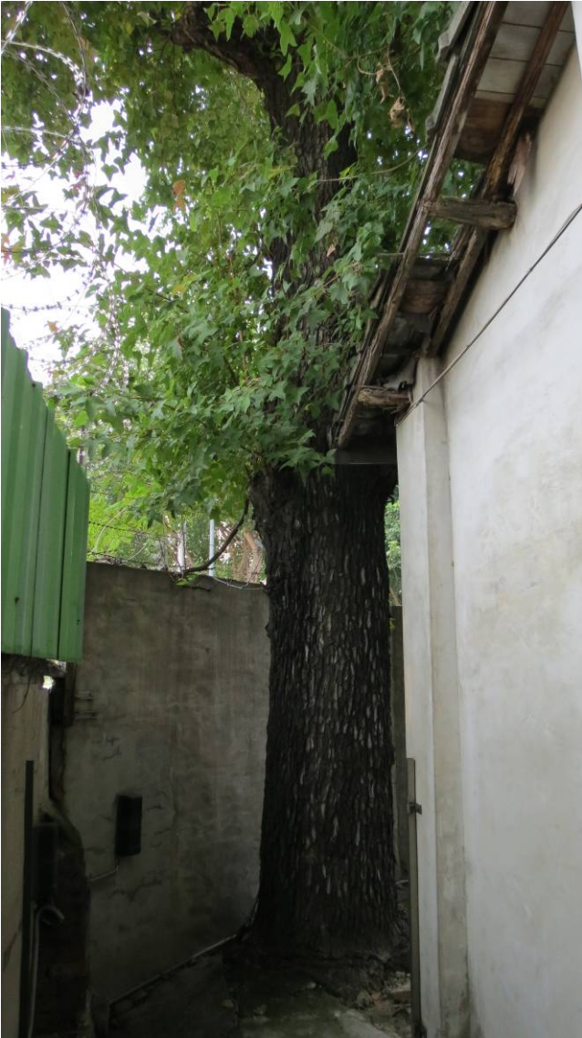
【圖 3-3- 29】楓香迫於圍牆及建築間隙地根系破壞建築
