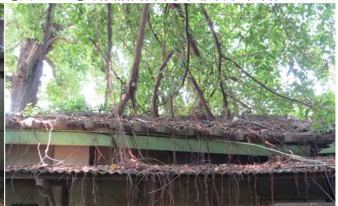
【圖 3-3- 28】榕樹氣根已造成屋頂破壞
