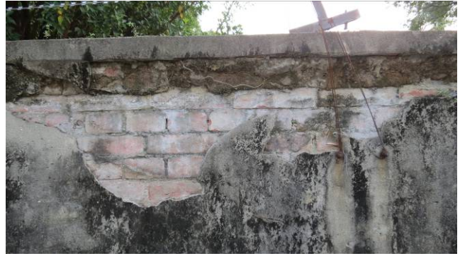
【圖 3-3- 5】圍牆粉刷層剝落紅磚外露
