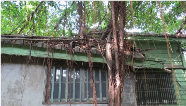
【圖 3-3- 49】榕樹氣根直接穿透破壞屋頂
