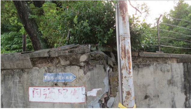
【圖 3-3- 4】自由路一段圍牆轉角植物附生損毀
