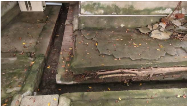
【圖 3-3- 12】建築物右側排水為榕樹根系破壞
