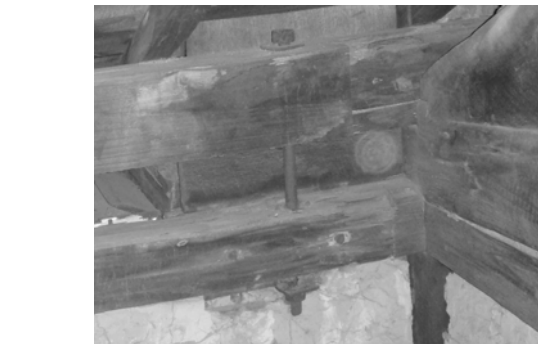
【圖 3-4-87】單邊長螺栓使用現況。
