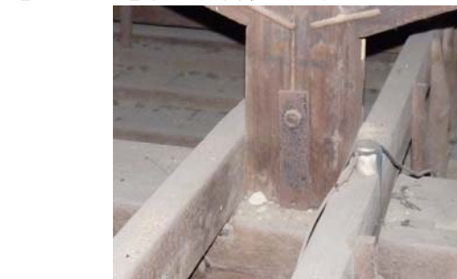
【圖 3-4-85】箱型鐵件使用現況。
