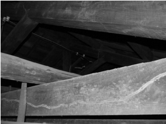
【圖 3-4-74】洋館屋架的水平大樑亦有蟻道。
