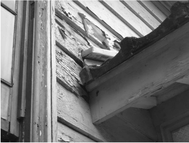
【圖 3-4-60】雨淋部分脫漆及腐朽
