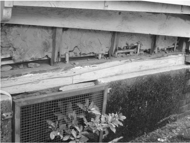
【圖 3-4-46】破損處可見內部構造
