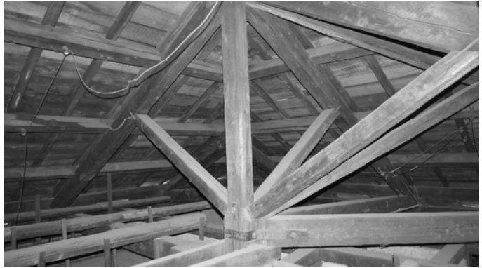
【圖 3-4-64】單組屋架現況照片。
