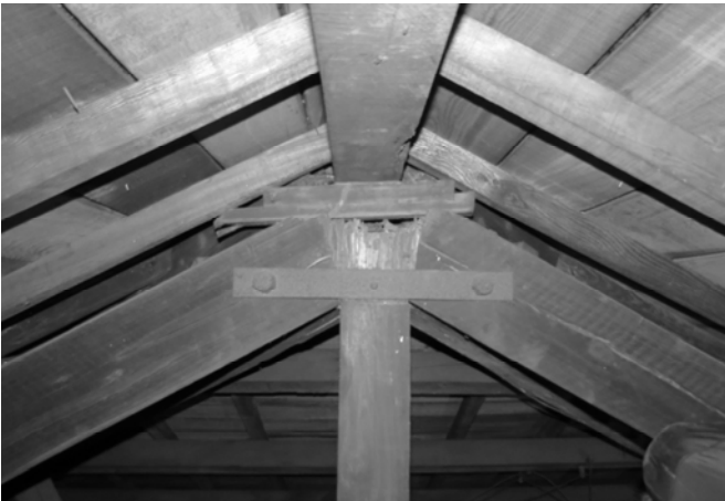
【圖 3-4-67】和館中柱式屋架中柱受白蟻蛀蝕損壞情形。
