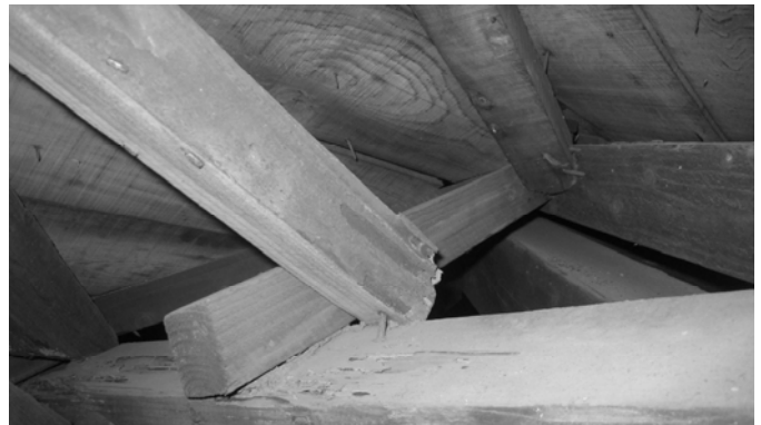
【圖 3-4-80】兩組四個屋坡交接處，屋面板轉折與搭接複雜。
