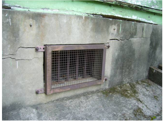
【圖 3-4-61】牆基通氣口因鏢栓鑽孔而開裂
