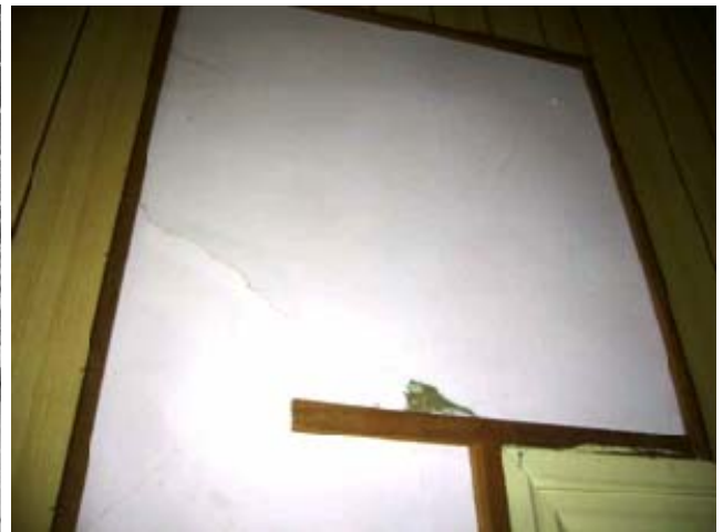
【圖 3-4-59】洋館室內壁面亦以夾板封住，破損處可見舊有粉刷層
