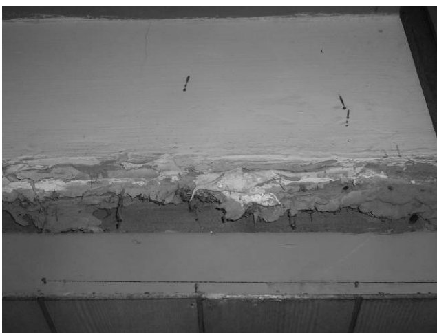
【圖 3-4-53】新增夾板裝修壁破了原有粉刷層
