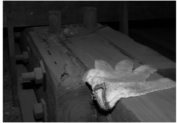
【圖 3-4-73】水平大樑上受到白蟻蛀蝕情況嚴重。
