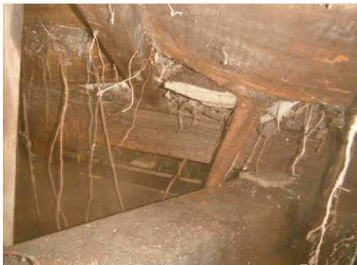
【圖 6-1-7】榕樹氣生根生長至屋架層，造成屋頂破損
