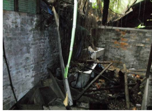
【圖 6-1-19】浴場左後方榕樹氣生根生長旺盛，亦堆放過多廢木料。
