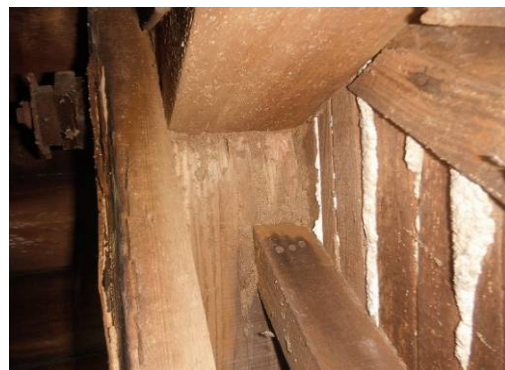
【圖 6-1-10】人字樑及斜撐交界處遭白蟻危害
