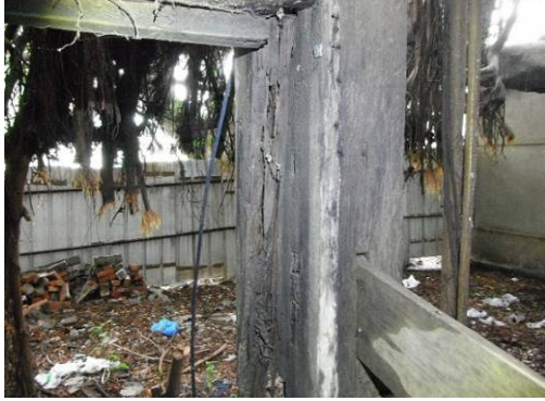
【圖 6-1-18】浴場後方立柱遭白蟻蛀蝕。
