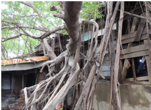
【圖 6-1-15】浴場後方榕樹氣生根以深入建築結構體中
