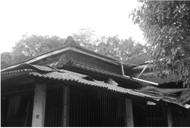
【圖 3-4-129】洋館和館交接處的落水管損壞情形
