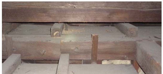
【圖 3-4-98】鼻母屋、桁、柱卡樁現況
