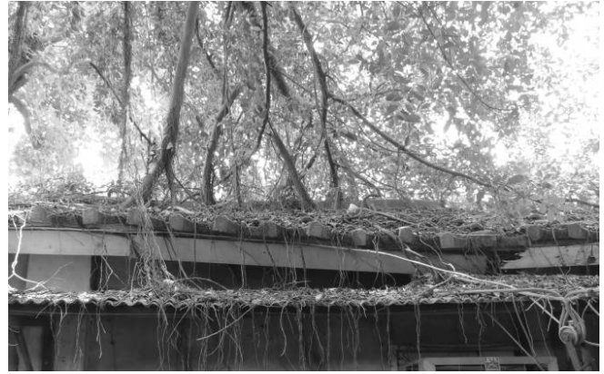
【圖 3-4-130】受到榕樹氣根破壞的屋頂。
