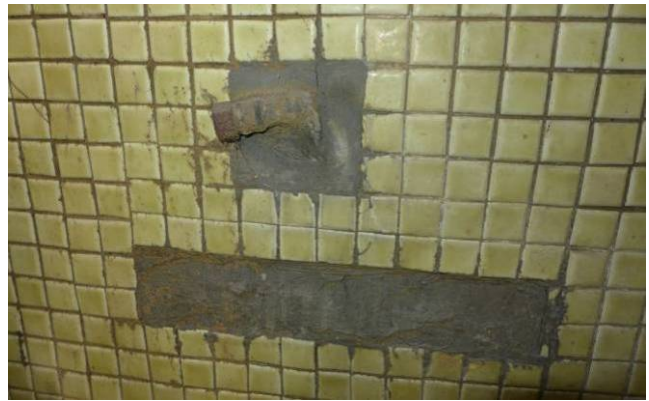
【圖 5-3-119】遺留的給水管痕跡
