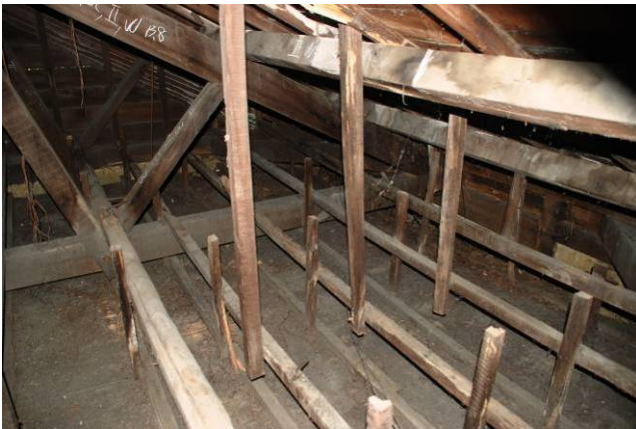
【圖 5-3-79】天花板的吊架設置緊密
