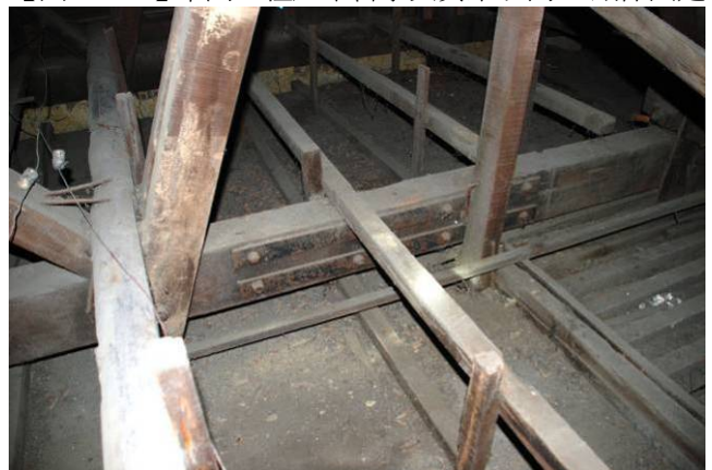
【圖 5-3-66】中間三組屋架陸樑使用兩片一字型鐵件補強樑接處
