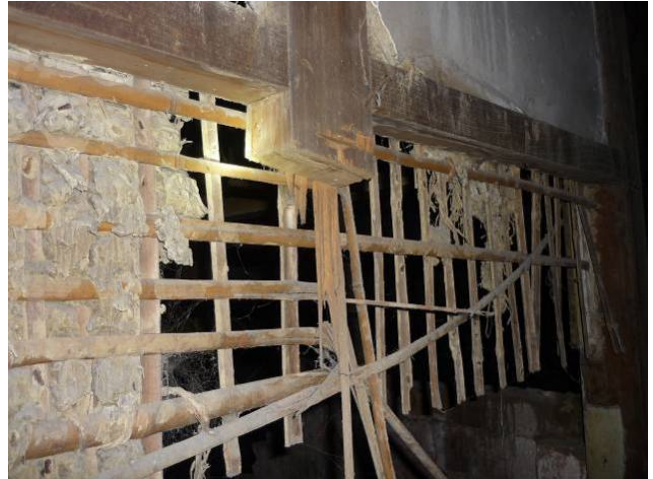
【圖 5-3-29】女更衣場與廁所間隔牆，壁體破損外露，柱子被鋸斷
