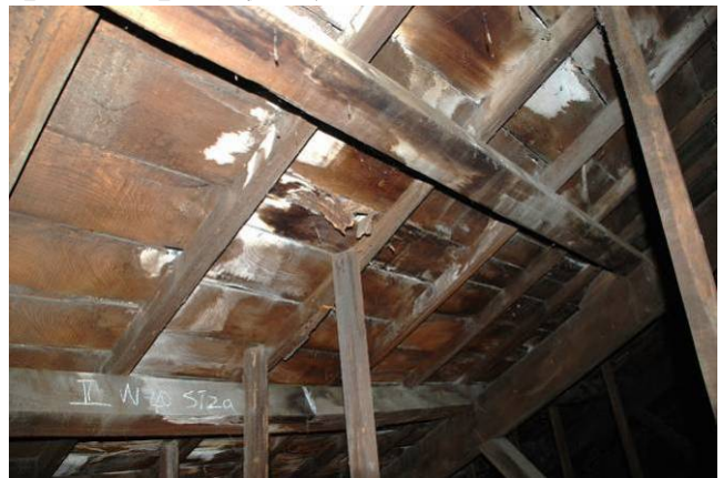
【圖 5-3-85】屋面板受損嚴重
