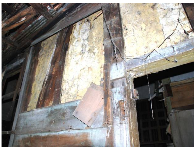
【圖 5-3-21】更衣場山牆側之外牆，雨淋板破損，可見其真壁構造、柱子及筋違
