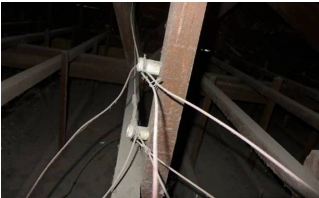
【圖 5-3-116】位於屋架上的碍子及電線
