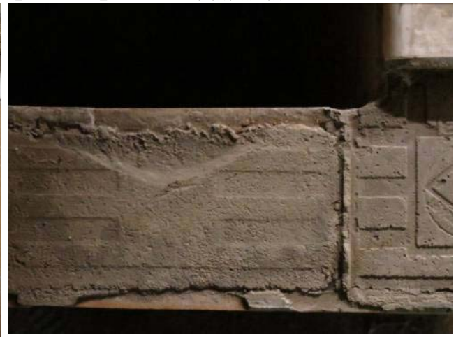
【圖 5-3-100】損壞處可見灰泥痕跡，可知磁磚背面形式
