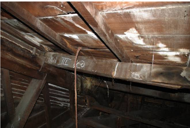
【圖 5-3-84】榕樹氣根直接穿過屋面板進入屋架
