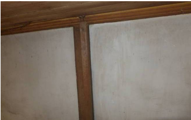
【圖 5-3-118】安裝於室內，保護電線用的方形木管
