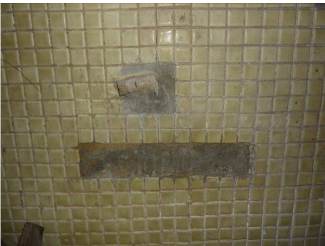
【圖 5-3-103】相對於水槽的位置的水管及構造物痕跡 八、門窗
