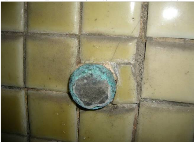
【圖 5-3-120】遺留的給水管痕跡，表面生了銅綠
