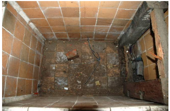
【圖 5-3-98】女浴室的水槽內及槽底
