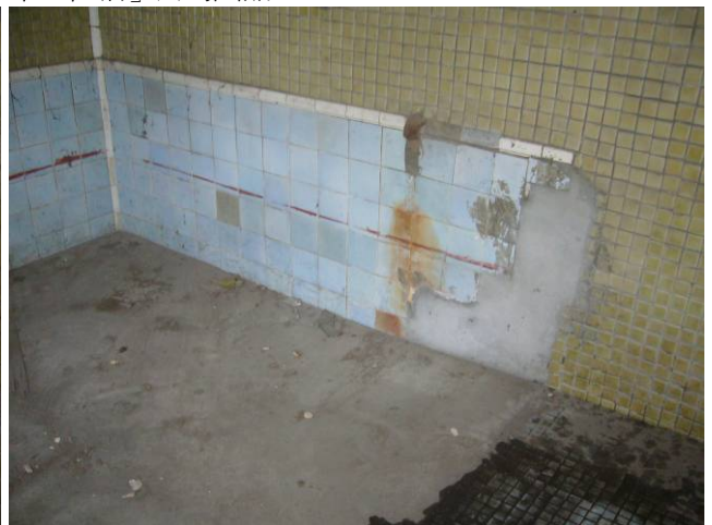
【圖 5-3-104】男女浴室的泡澡池底均被水泥填實
