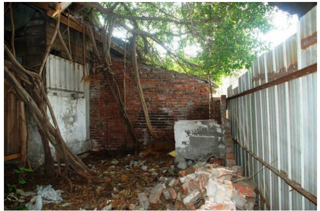
【圖 5-3-2】加蓋建物遮蔽了犬走及排水溝
