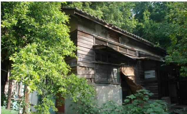
【圖 5-3-30】浴場的外牆構造層次由三種壁體構成。紅磚砌、真壁、木摺壁
