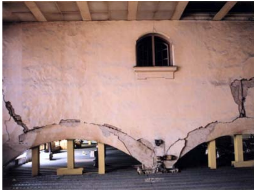
地震後受損之拱樑及柱頭
