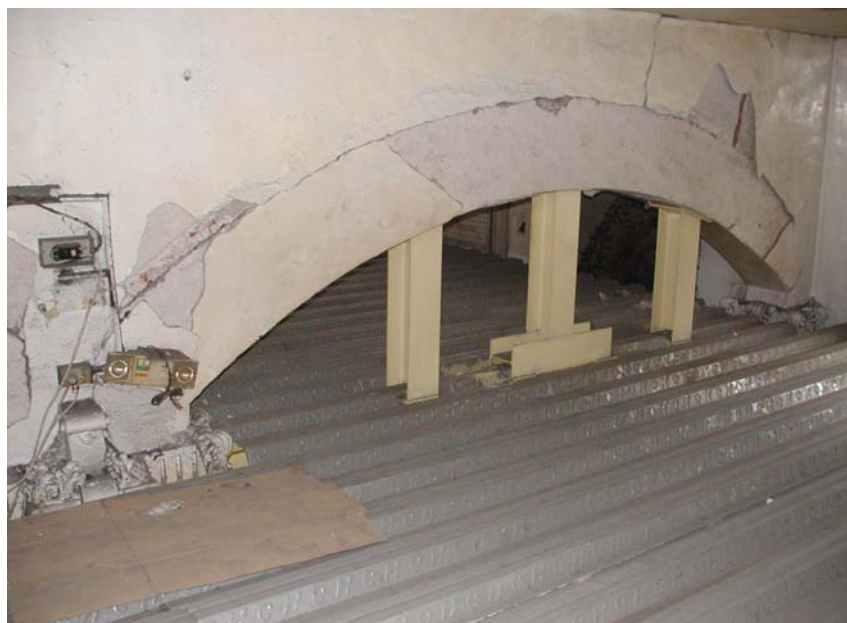
照片 3-5-2 九二一地震後之防護鋼板
