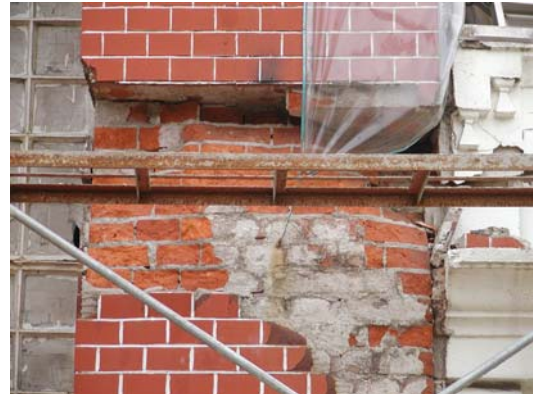
地震力撕裂上下部份錯開之承重磚牆
